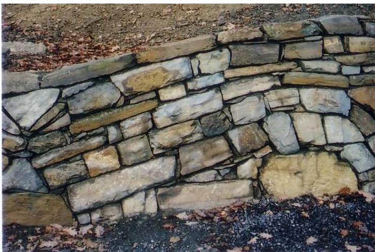
Photo 8 : plissement dans une maçonnerie sèche
